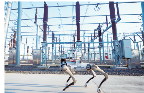
四足机器人在220千伏武黄变电站开展精益化巡视。
