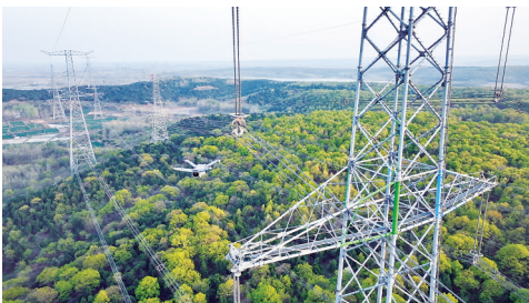
旋翼无人机机动巡航与输电铁塔上的高清摄像头定点监控相结合,构建输电线路“动静结合”防护网。
